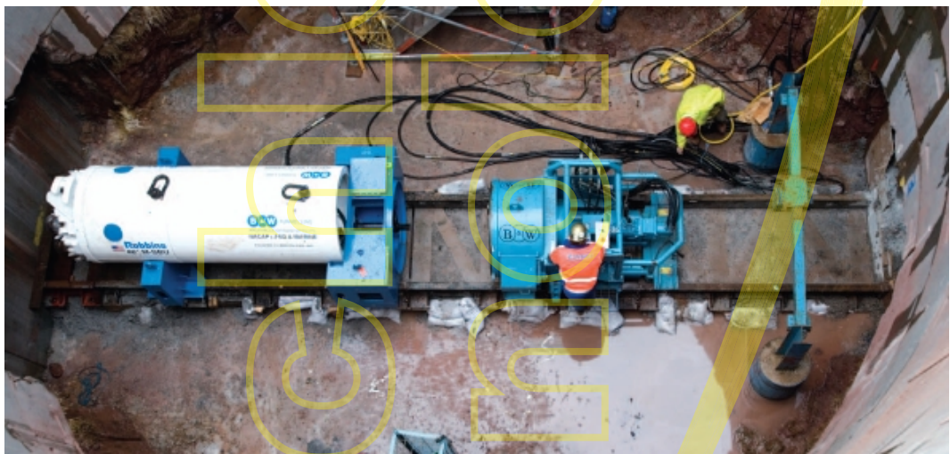
Figura 4 - SBT – una Small Boring Unit motorizzata nel pozzo di partenza prima dell’inizio della perforazione (per gentile concessione della The Robbins Company – USA).
