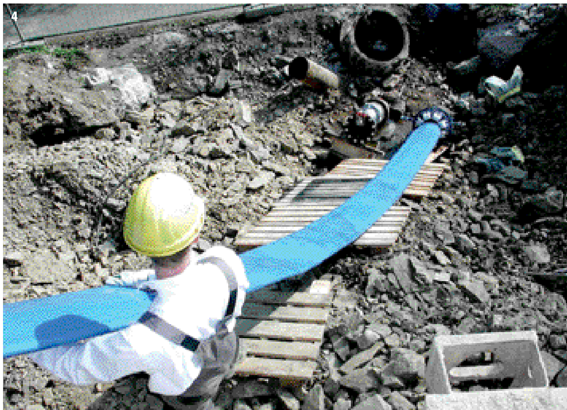
4. Applicazione del PRIMUS-LINE® nella riabilitazione di una condotta in acciaio: il liner viene inserito nella condotta ospite (per gentile concessione di S3 Soncini SpA)
